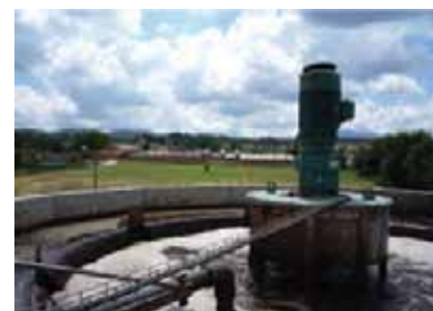
Instal·lació de tractament de purins de porc mitjançant nitrificació-desnitrificació.
